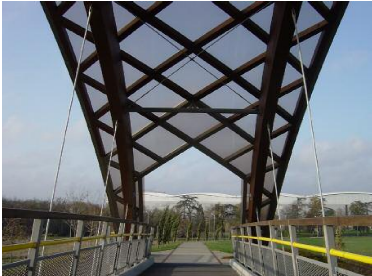
Photo 7: Vue intérieure de la passerelle Pinot, de 36m de portée. Les arcs sont en bois, les tirants et suspentes en acier et la dalle en béton.
